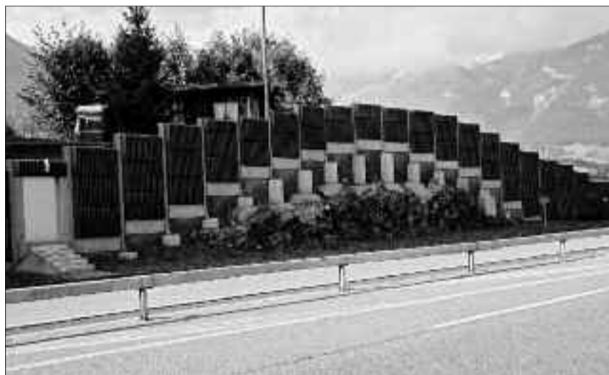
Dem Gelände angepasste Lärmschutzwand bei Sarnen.
